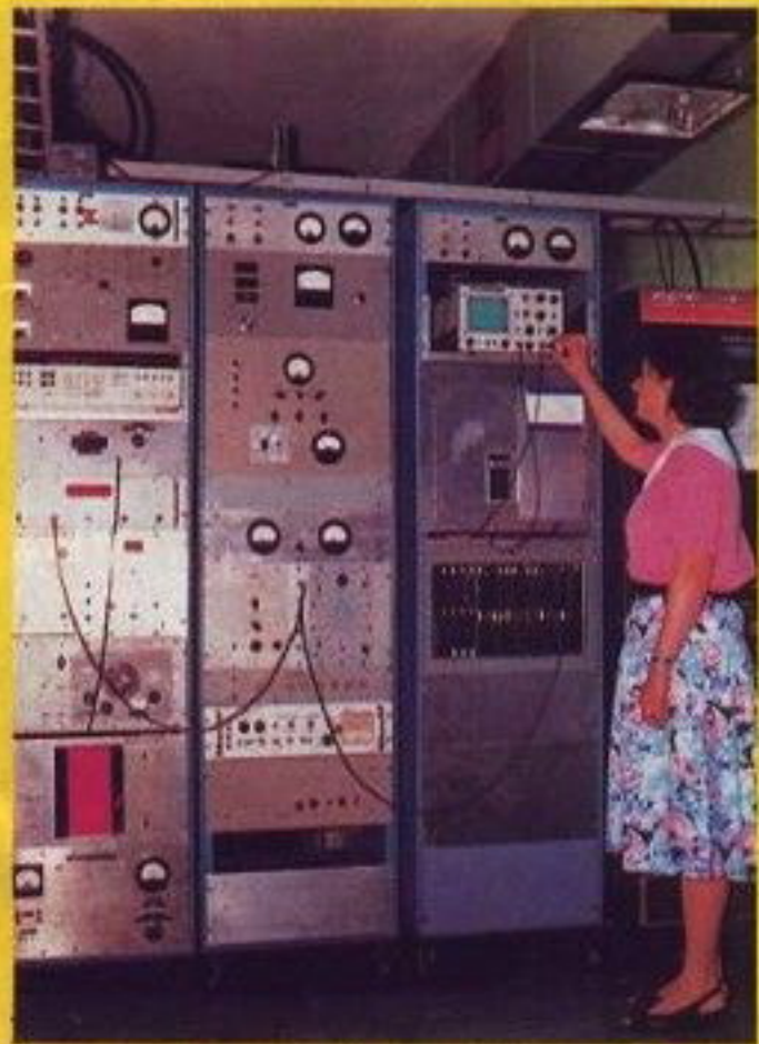
Instalaciones del equipo receptor, línea 21 cm operando en observaciones.
